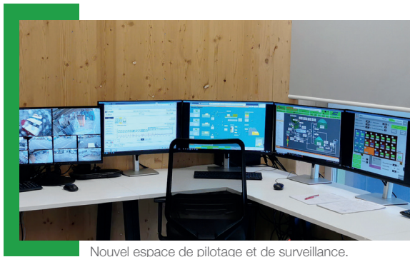
Nouvel espace de pilotage et de surveillance.
